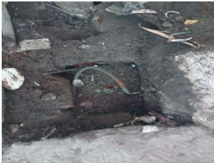
Gambar Konduktor Pada Gedung D
