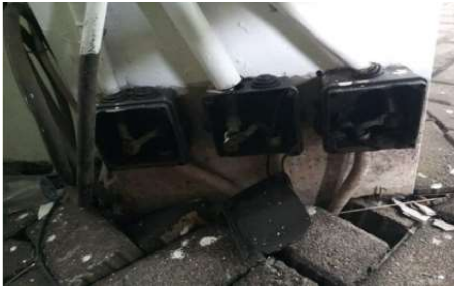
Gambar Konduktor Pada Gedung MCEB
