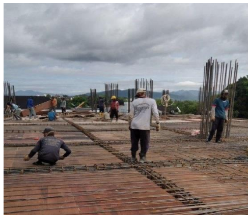
Gambar 3. Beberapa pekerja tidak mengenakan rompi pelindung sebagaimana yang dipersyaratkan dalam standar keselamatan kerja.
