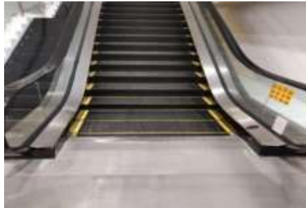
Gambar 4.1 Kerusakan Eskalator di Lantai 2
