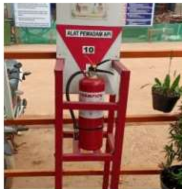
Gambar 5.17 Alat pemadam api dilokasi proyek (Sumber : Dokumentasi Peneliti 2022)
